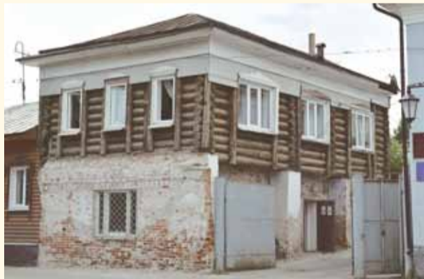
Уничтожение исторического облика здания на Ленина, 30 в ходе текущей реконструкции
